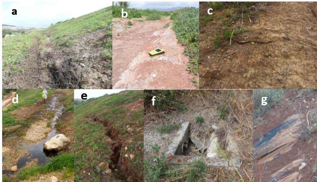
Fig. 1. Tipos de danos que se podem observar em infra-estruturas de aterro (controlado/não controlado) após o seu encerramento: (a) empolamento na base de taludes instáveis; (b) assentamentos; (c) erosão do solo de cobertura; (d) exsurgência de lixiviados; (e) abertura de fendas de tracção; (f) órgãos de drenagem danificados; (g) escorregamento de solos de cobertura sobre geomembrana.
